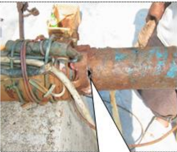
Ống dây bị thủng
