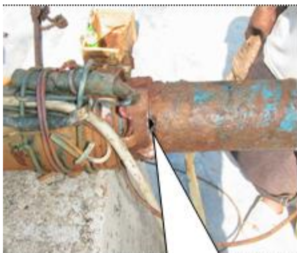
Ống dây bị thủng
