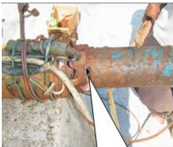
Ống dây bị thủng
