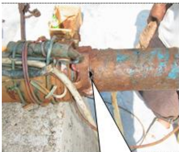
Ống dây bị thủng
