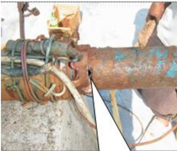
Ống dây bị thủng
